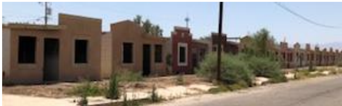
Figura 28. Vivienda abandonada en el Área de Estudio. Fuente. - Elaboración propia
